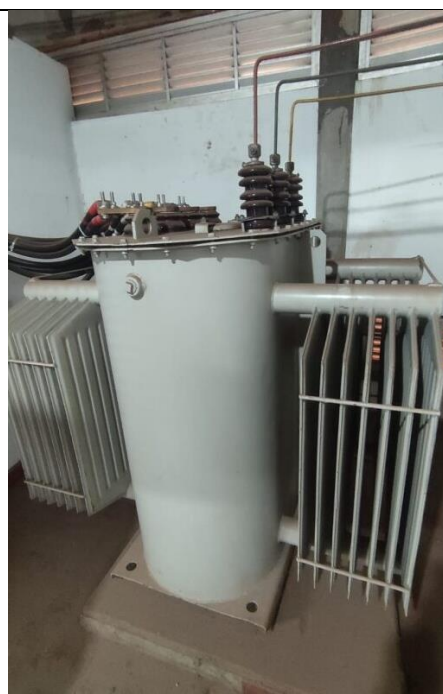
2. Trafo a óleo 500 kVA
