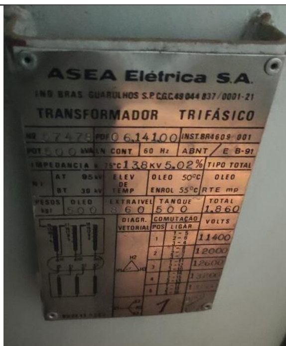
1. Trafo a óleo 500 kVA
