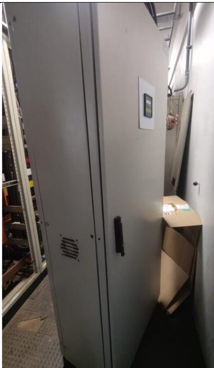
1. Banco de capacitores
