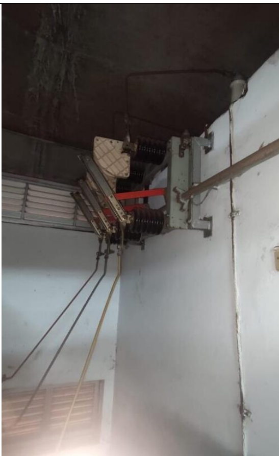
1. Seccionadora Média Tensão
