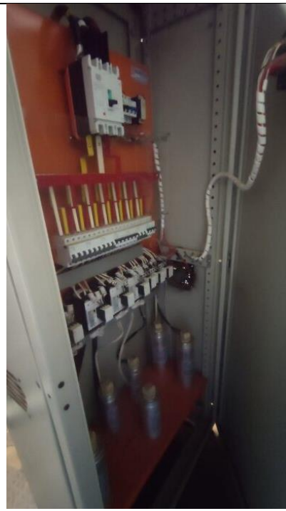
2. Banco de capacitores
