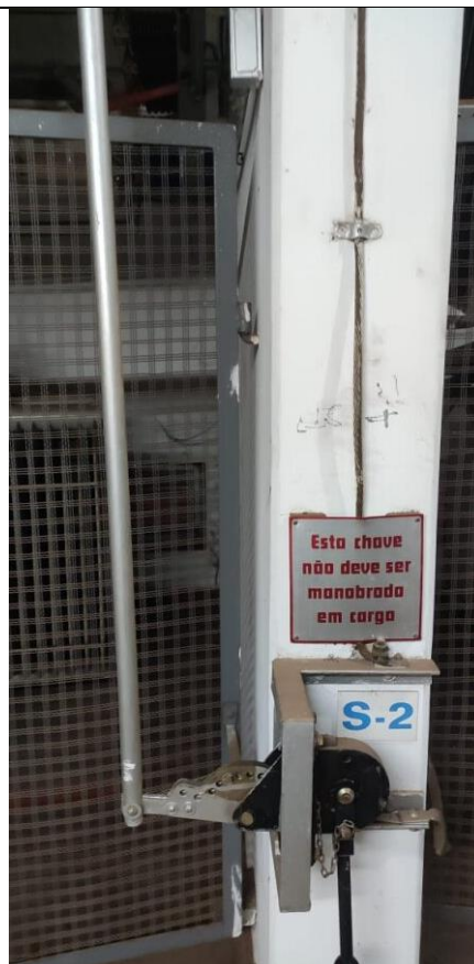
2. Seccionadora Média Tensão
