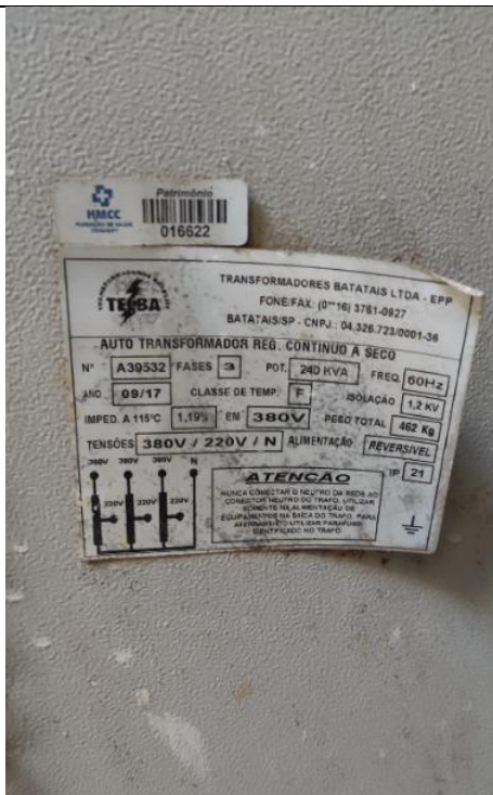
1. Auto Trafo a Seco 240kVA
